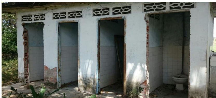
Figura 4. Estado actual de los baños de la escuela Guatavita Tua.
