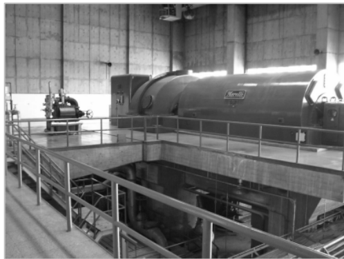
Fig.1. Turbina a vapor de acción y reacción y generador eléctrico 60 MW
